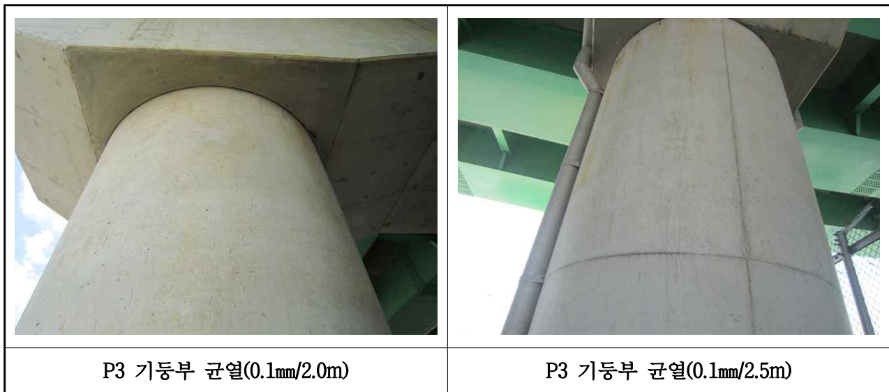
【사진 3.12】교각 손상현황
