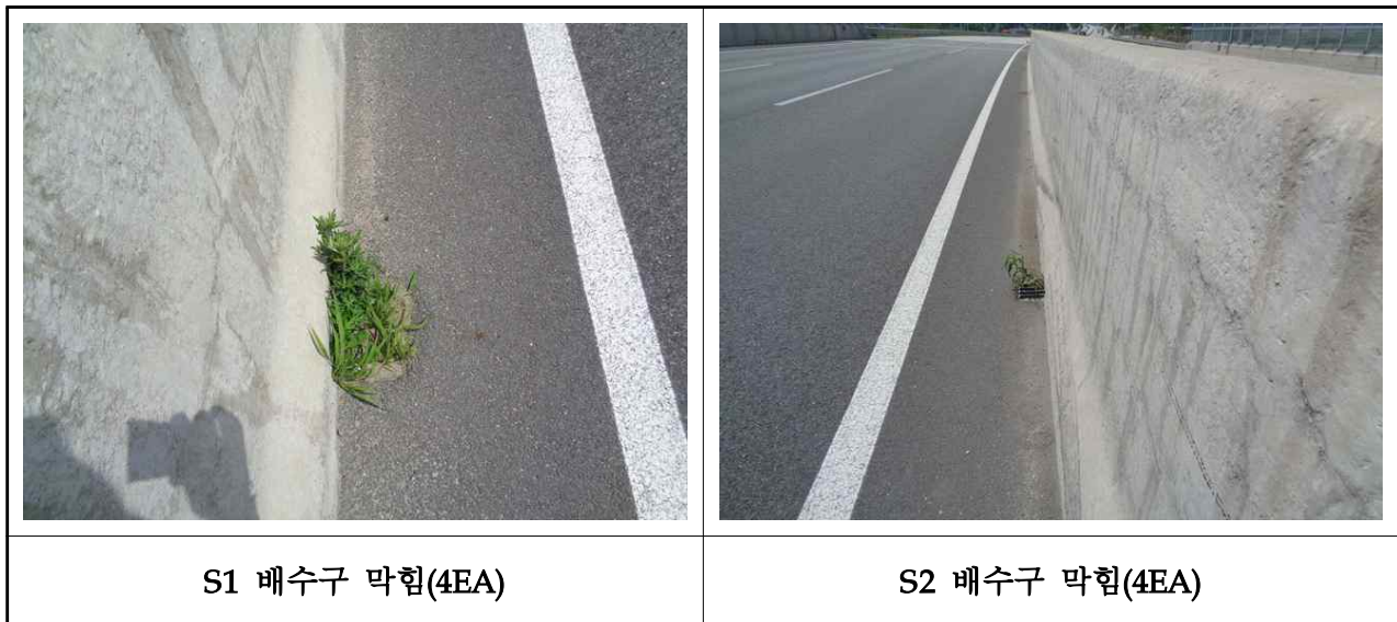
【사진 3.22】 배수시설 손상현황
